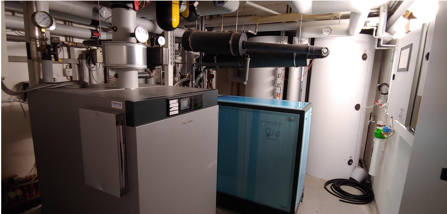
Überblick Heizzentrale mit BHKW, Spitzenlastkessel und Pufferspeicher
